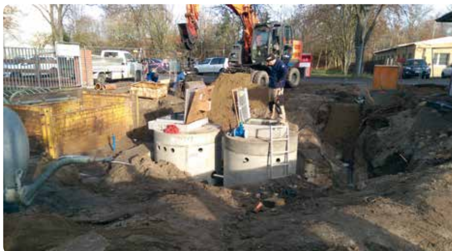
Das Pumpwerk nebst Armaturenschacht.
